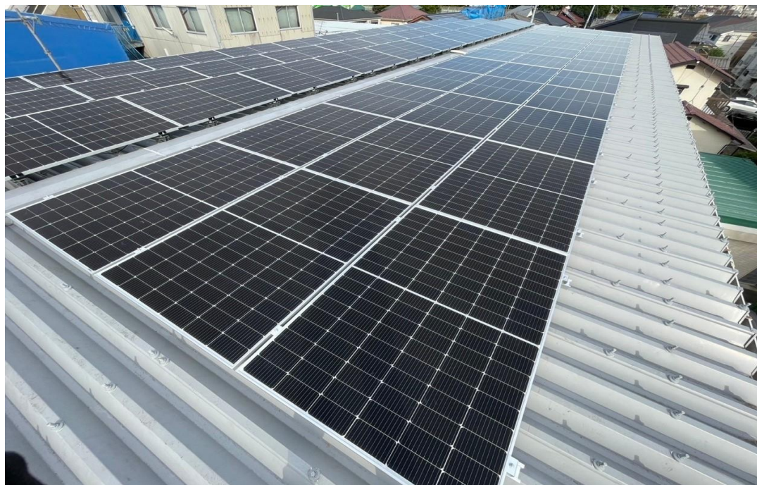
いずみ野工場に設置した太陽光パネル
